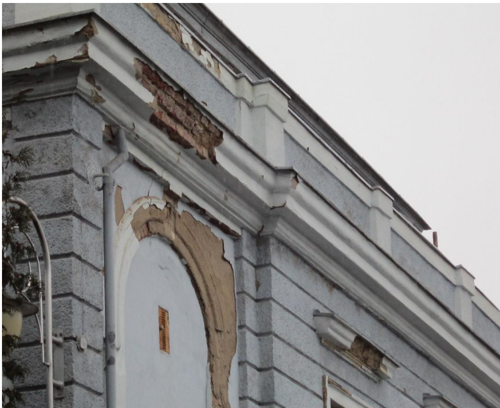
Ryc. 17 To samo miejsce, stan z 23.01.2021 r. – ukazane postępujące uszkodzenia wynikające z niewłaściwego zabezpieczenia budynku – ubytki w obrębie archiwolty i sąsiedniego naczółka okiennego (A.M.)
