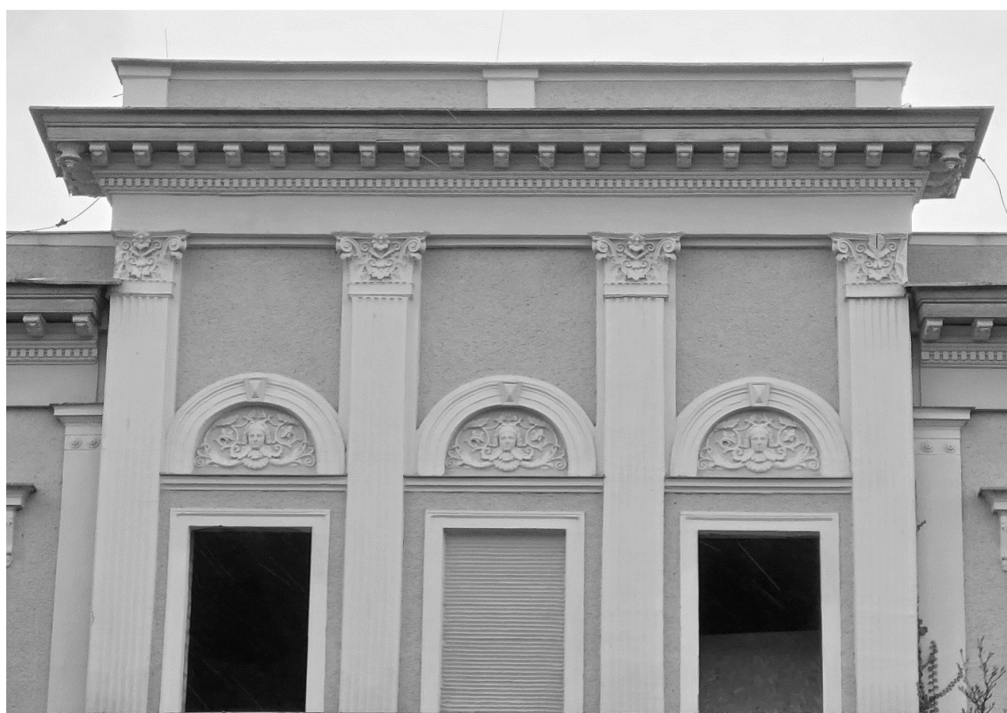
Ryc. 4 Góra - układ kompozycyjny pierwszego i drugiego piętra, dół - ryzalit frontowy z widocznym zaślepionym oknem i uszkodzonymi głowicami skrajnych pilastrów (A.M.)
