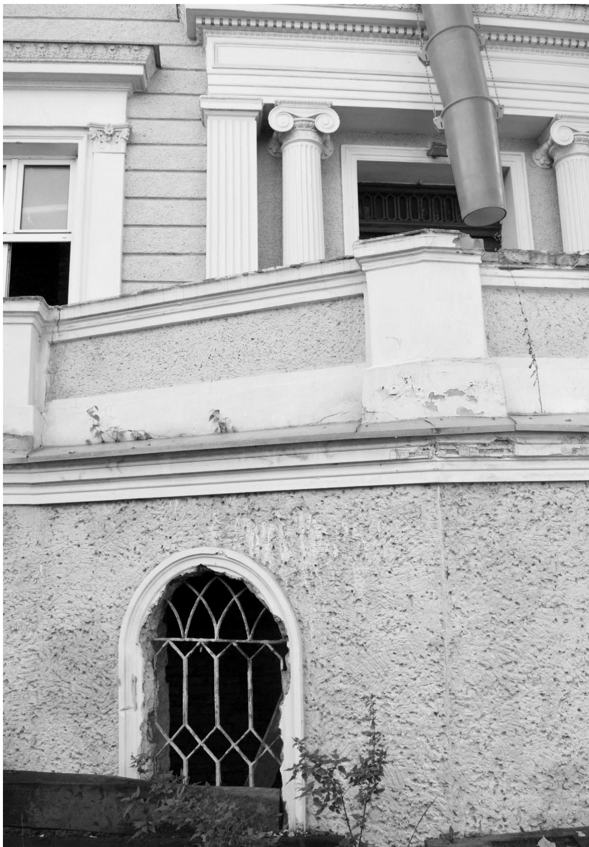
Ryc. 27 Uszkodzenia w obszarze przyziemia pod spocznikiem schodów od strony zachodniej. W tle widoczne elementy portalu zdobionego wejście główne (R.S.)
