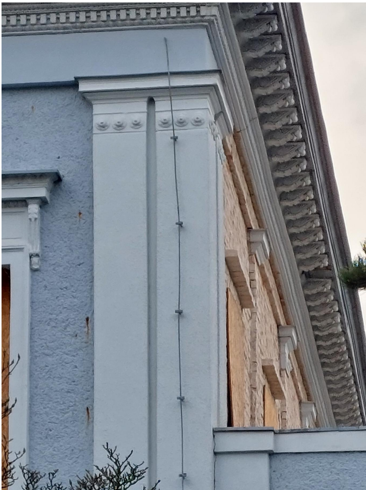
Ryc. 7 Zbliżenie zdwojonych w narożach budynku pilastrów drugiego piętra z trzema rozetkami w szyjach poniżej głowic. W tle ukazane również naruszenia detalu drugiego piętra elewacji wschodniej. Widoczny również jeden z ubytków w partii kroksztynów (A.M.)
