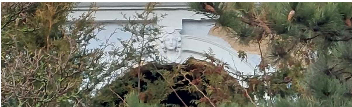
Ryc. 19 Zbliżenie detalu łuku okna weneckiego w południowej ścianie skrzydła pod wschodnim tarasem. Zauważalne jest narastające odspojenie tynku i pęknięcia związane z przemakaniem, zagrażające ostatniej zachowanej kopii motywu kobiecej maski zdobiącej zwornik archiwolty (stan z 17.02.2022 r., A.M.)
