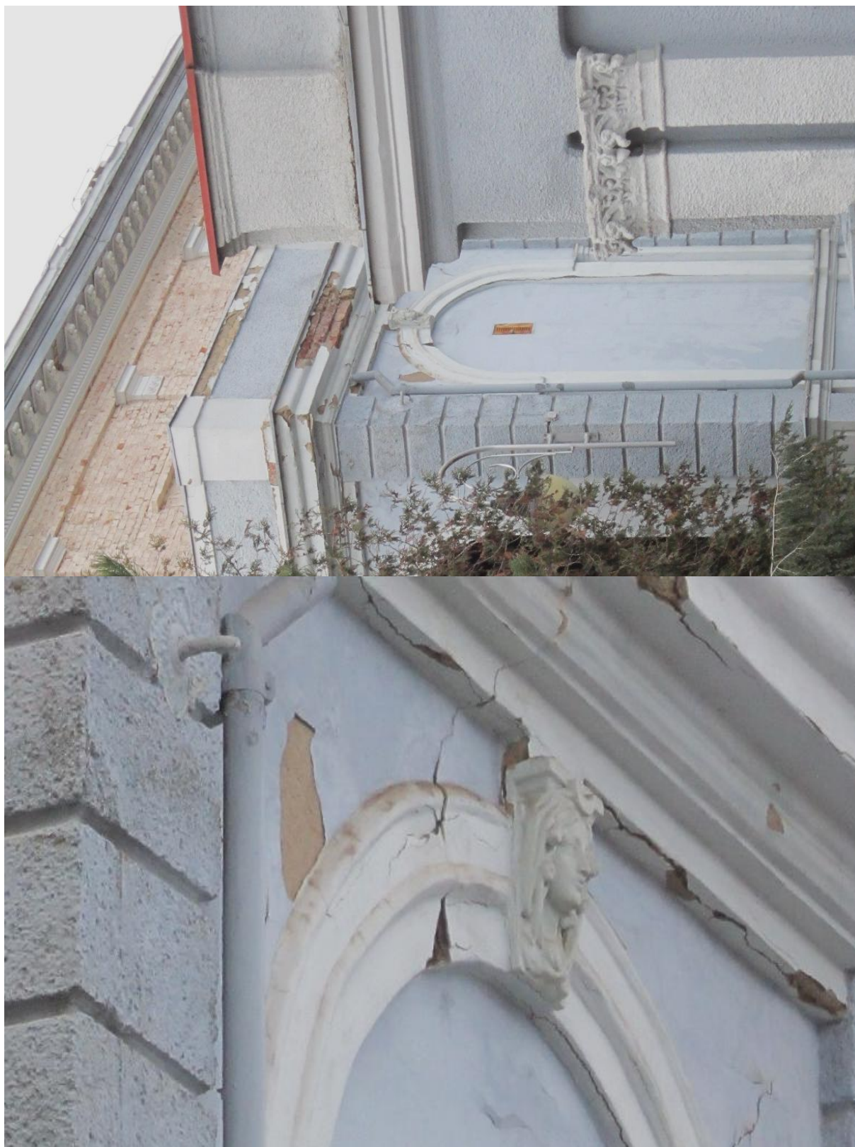
Ryc. 16 Stan zachowania obramień wschodniego okna weneckiego na dzień 13.01.2021 r. Góra – widoczne uszkodzenia tynku na gzymsie tarasu, dół – zbliżenie detalu zwornika archiwolty – maski kobiecej (A.M.)
